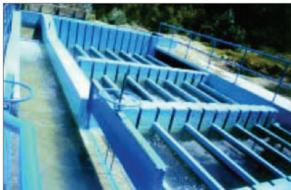
Figura 2-6. Floculadores hidráulicos de flujo vertical.
