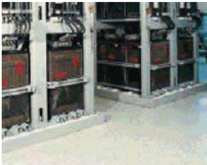
Figura 0-5: Batería de plomo-acido (Fuente: EPRI)
