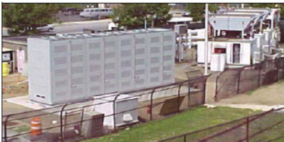
Figura 0-6: Batería de Sodio sulfuroso de 1.2 MW/7.2 MWh instalada en el sistema de New York Power Authority (NYPA)
