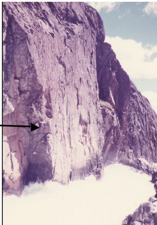
Foto N° 4 - Margen izquierdo del Río Carrenleufu, en zona de empotramiento, presa de arco (detalle).
