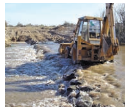
CONTROL DE INUNDACIONES
