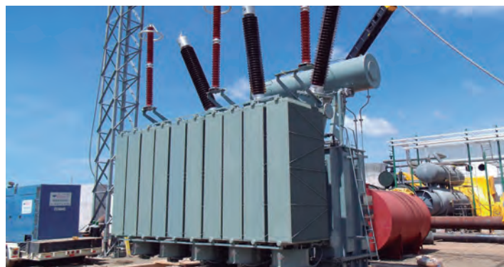
Figura 11: Transformador de Potencia. 500 KV/ 132 KV.
