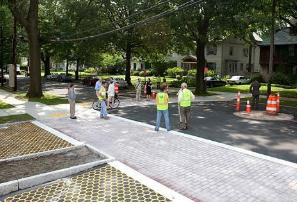
Imagen N°37: Transformación de una calle tradicional en una Calle Completa cercana a una intersección con altos niveles de siniestralidad en la ciudad de New Haven. Fuente: http://www.newhavensafeststreets.org/2010/12/speed-table-and-curb-extensions-coming.html
