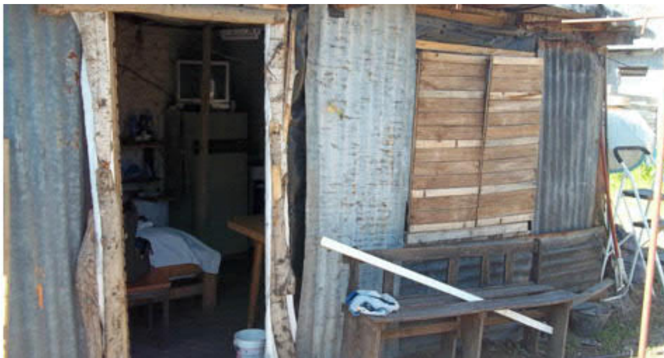
Imagen 16: Vivienda irrecuperable. Contribuye al déficit habitacional cuantitativo.
