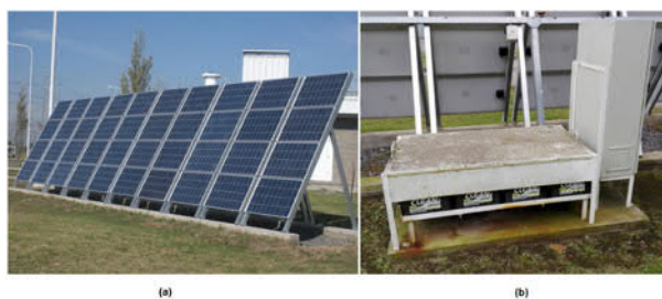
Figura N/8: Implementación de panel solar. (a) Conjunto de módulos fotovoltaicos (b) Banco de baterías.
